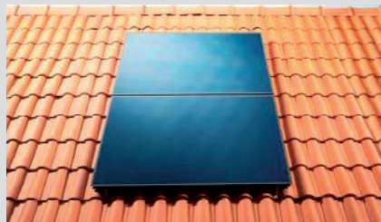
Instalação sobre telhado inclinado
